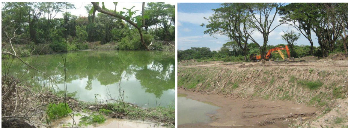
Figura 62. Instalaciones para el tratamiento de aguas residuales en Becerril.
