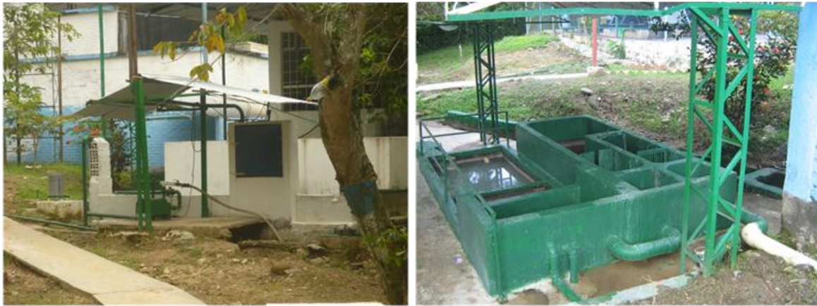
Figura 2. Instalaciones para el tratamiento de aguas residuales en la empresa “Enfriadora La Vallenata”.
