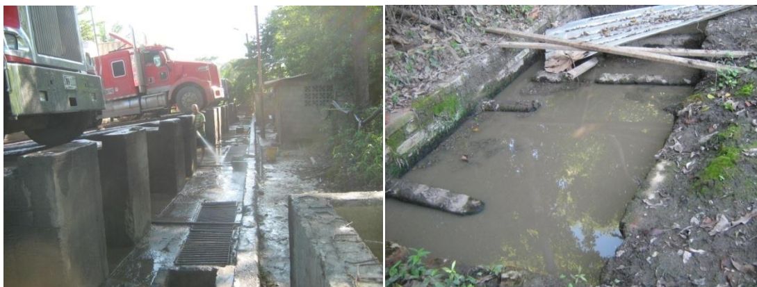
Figura 89. Instalaciones para el tratamiento de aguas residuales en el parador La Cabaña.
