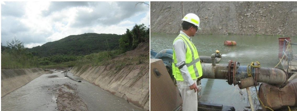
Figura 81. Instalaciones para el tratamiento de aguas residuales en CDJ.
