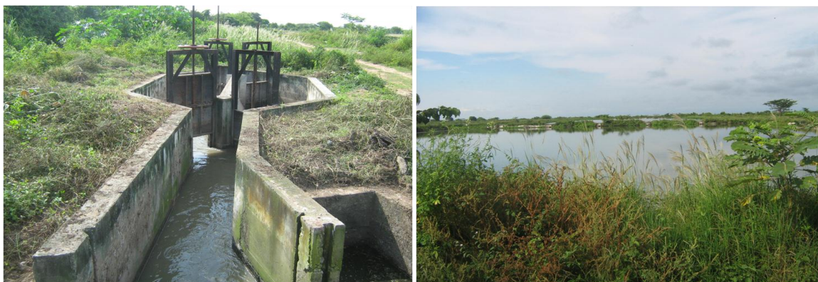
Figura 53. Instalaciones para el tratamiento de aguas residuales en Aguachica (sur).
