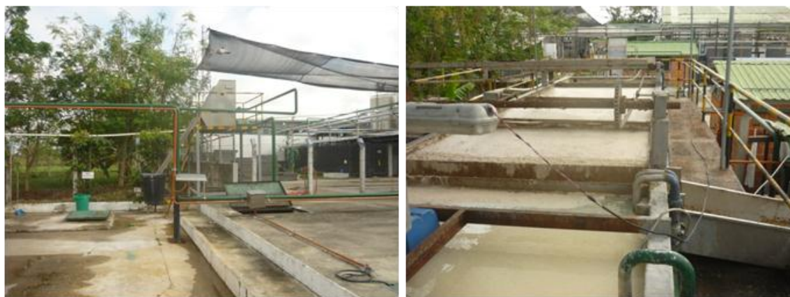
Figura 6. Instalaciones para el tratamiento de aguas residuales en la empresa "FRESKALECHE".
