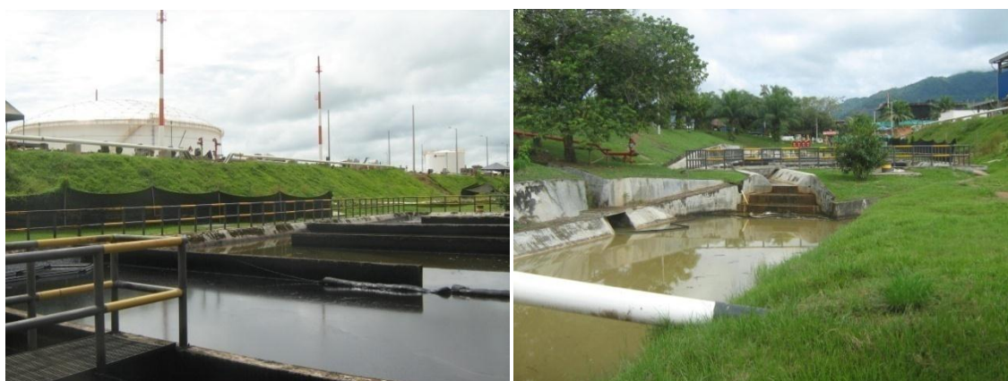
Figura 74. Instalaciones para el tratamiento de aguas residuales en la Planta Ayacucho (ECOPETROL).
