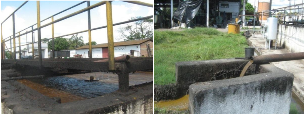
Figura 36. Instalaciones para el tratamiento de aguas residuales en la empresa Palmeras de la Costa.
