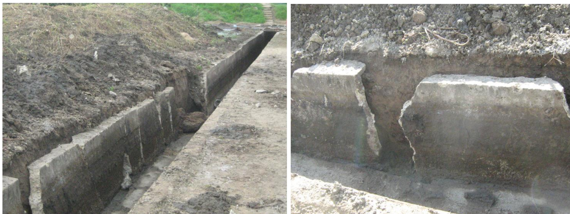
Figura 37. Daño en el canal que transporta los efluentes hasta el STAR en Palmeras de la Costa.
