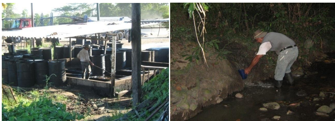
Figura 84. Instalaciones para el tratamiento de aguas residuales en LA EDS Rafael.
