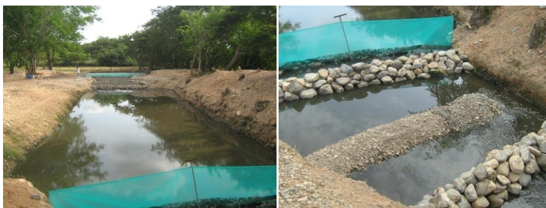
Figura 16. Instalaciones para el tratamiento de aguas residuales en la empresa FOGASA.
