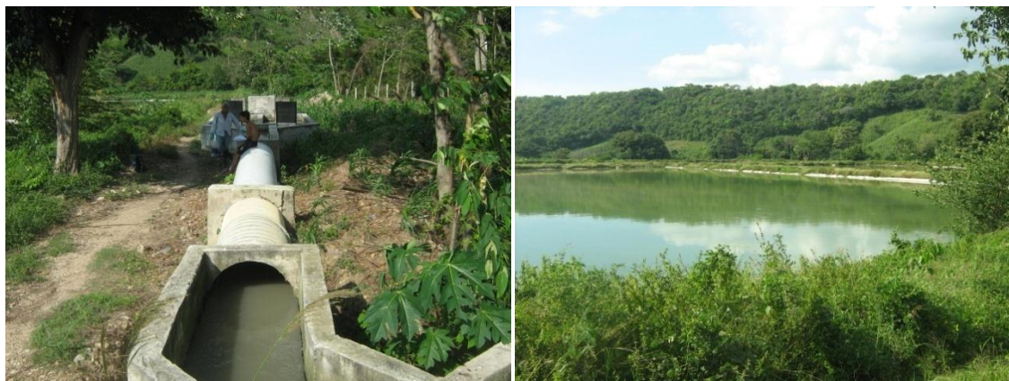
Figura 61. Sistema de tratamiento de aguas residuales (Jerusalén).
