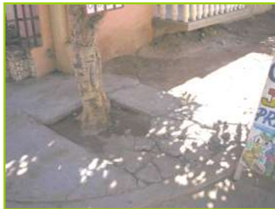
Foto 10. Grietas en zona dura del andén.
