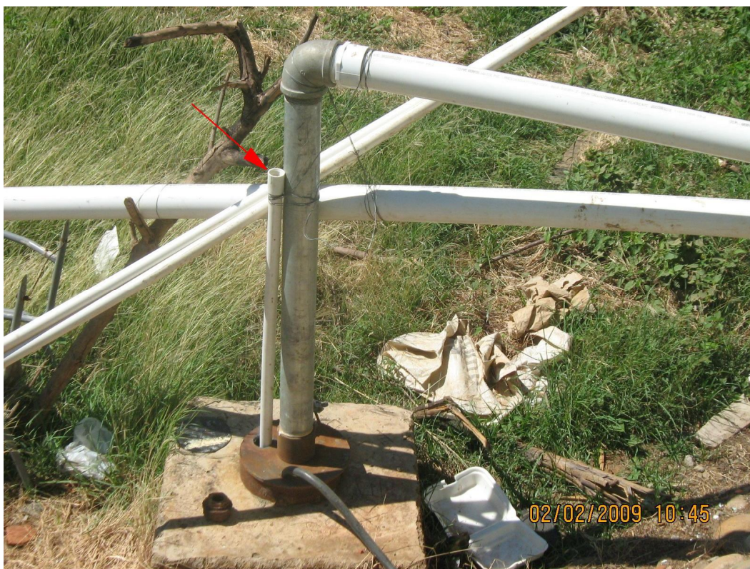
Foto 3. Tubería de \frac{3}{4} de pulgada de diámetro (indicada por la flecha) introducida en un pozo profundo para medición de niveles con sonda
