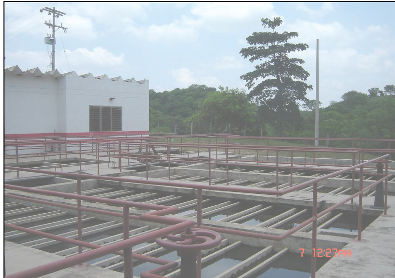
Foto 27. Planta de potabilización del municipio de El Copey.
