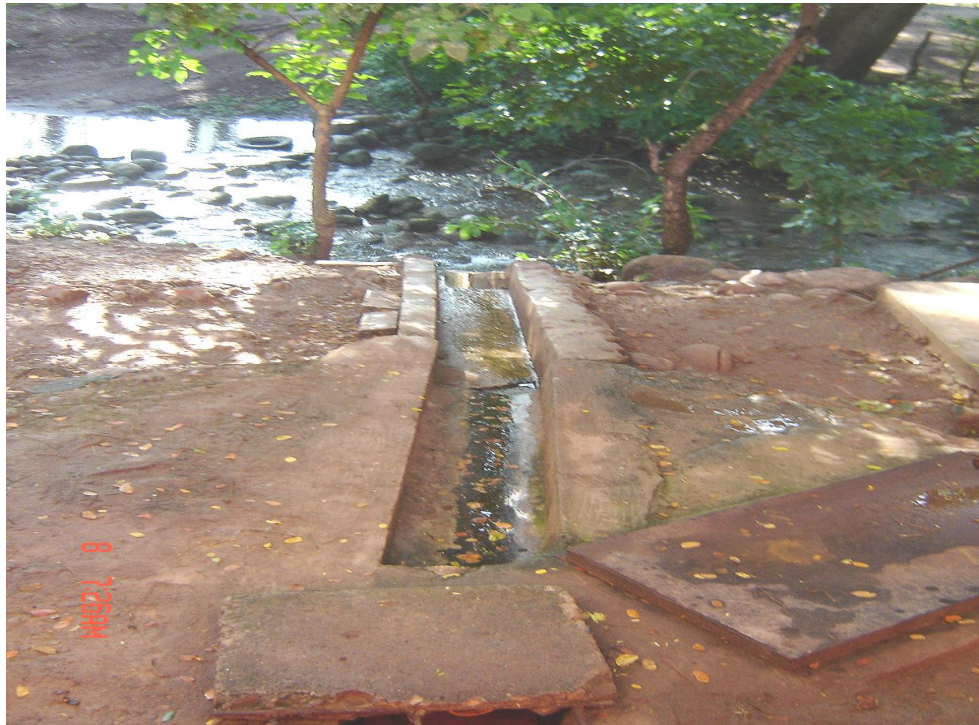
Foto 31. Canaleta de salida del agua residual proveniente del matadero del municipio de La Paz.
