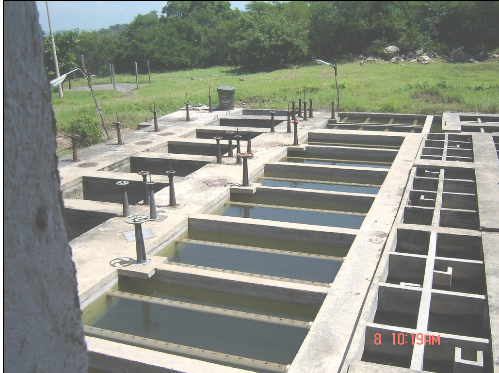
Foto 30. Planta de potabilización del municipio de La Paz.
