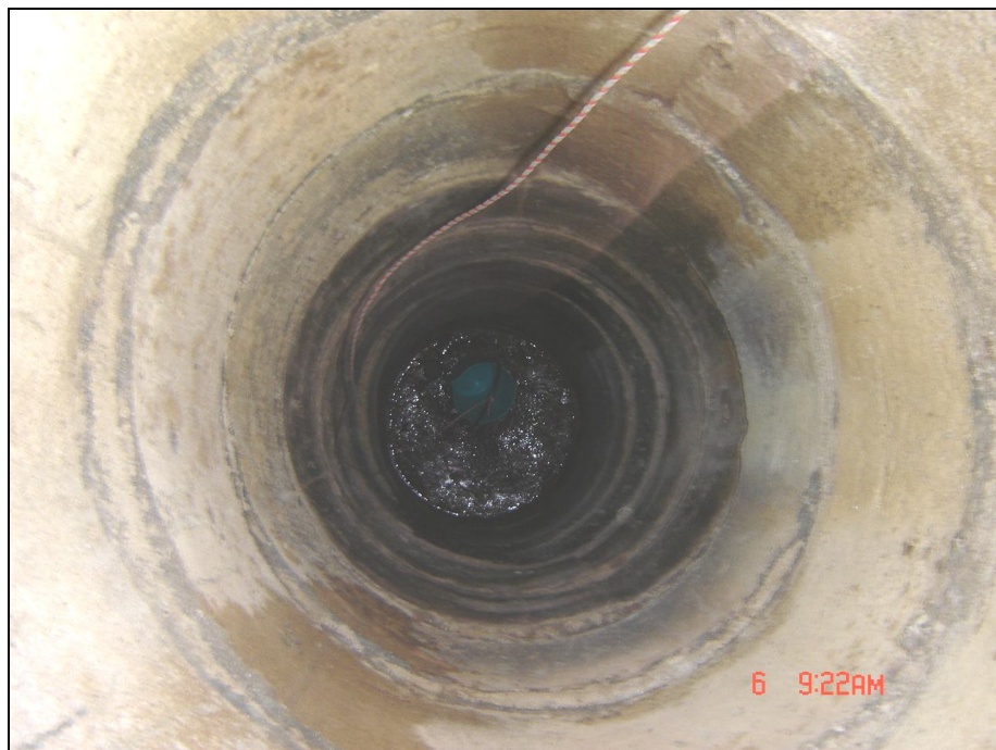
Foto 10. Aljibe con revestimiento en anillos de cemento.
