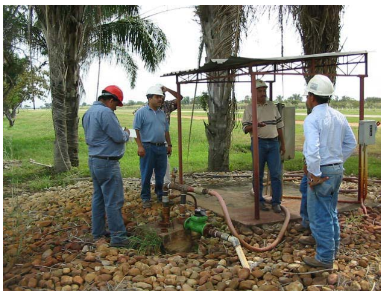
Foto 49. Pozo profundo Nro. 10, de la Compañía Drummond Ltd.
