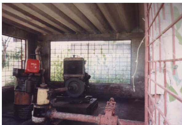
Foto 88. Zona operacional inapropiada de pozo profundo bomba de eje vertical con residuos aceitosos y combustibles.
