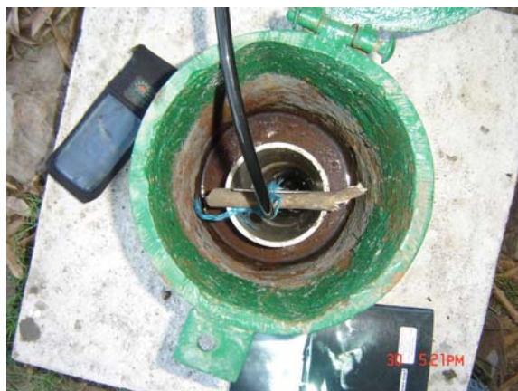
Foto 103. Instalación preliminar de una sonda de presión para registrar las variaciones en magnitud de los niveles estáticos en el piezómetro de Becerril
