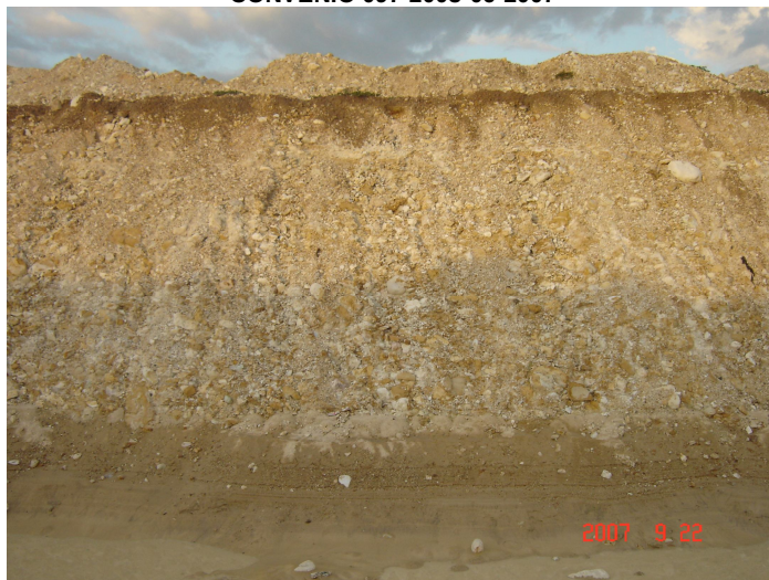
Foto 38. Depósitos de gravas y arenas en una matriz limo arcillosa del Cono Aluvial (Qcal2) en las celdas del relleno sanitario de Aguachica.
